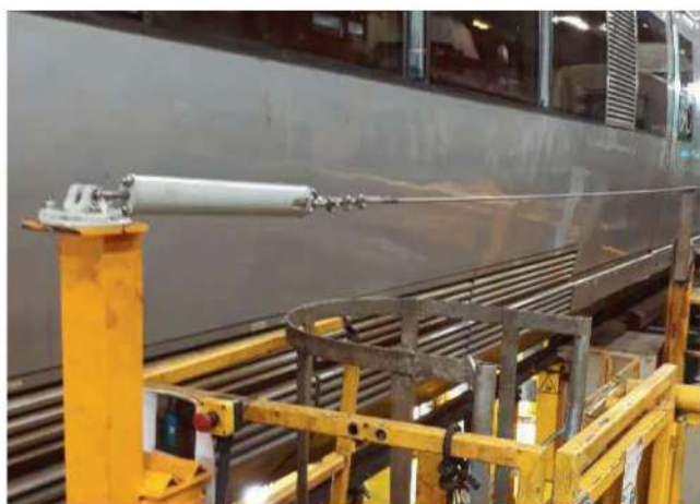
LIGNE DE VIE POUR ACCÈS À UNE PASSERELLE INFÉRIEURE D'un côté, mise en place d'une fixation (point d'extrémité) sur charpente existante. De l'autre côté, installation d'un poteau sur-mesure avec fixation par scellement chimique.
